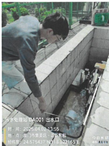
污水处理站 DA001 出水口
