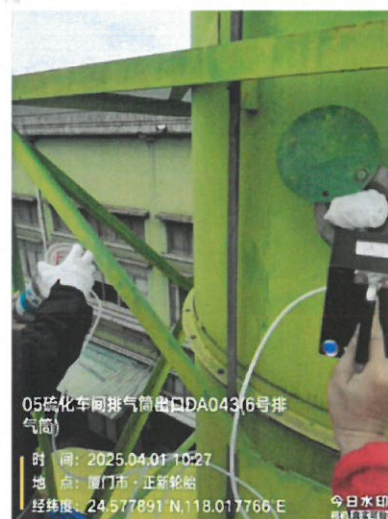
05 硫化车间排气筒出口 DA043 (6 号排气筒)
