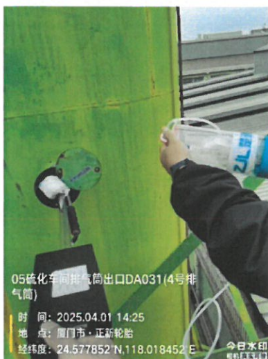
05 硫化车间排气筒出口 DA031 (4 号排气筒)
