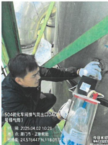
504 硫化车间排气筒出口 DA029 (25 号排气筒)
