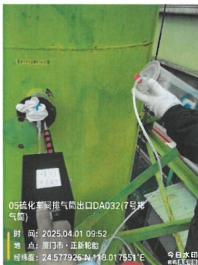
05 硫化车间排气筒出口 DA032 (7 号排气筒)
