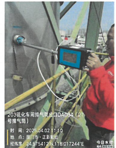
203 硫化车间排 气筒 A034 (27 号排气筒)
