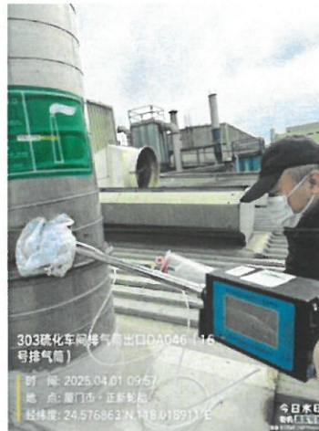
303 硫化车间排气筒出口 DA046 (16号排气筒)
