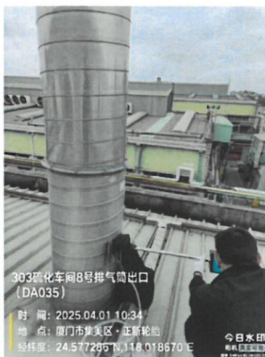
303 硫化车间排气筒出口 DA035 (8 号排气筒)
