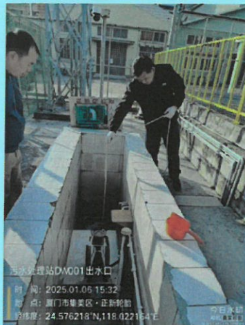
污水处理站 DW001 出水口
