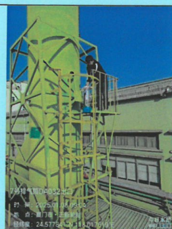
05 硫化车间排气筒出口 DA032 (7 号排气筒)
