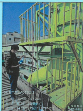
05 硫化车间排气筒出口 DA043 (6 号排气筒)
