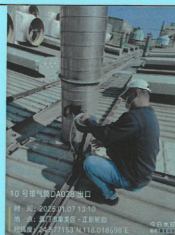
303 硫化车间排气筒出口 DA038 (10 号排气筒)
