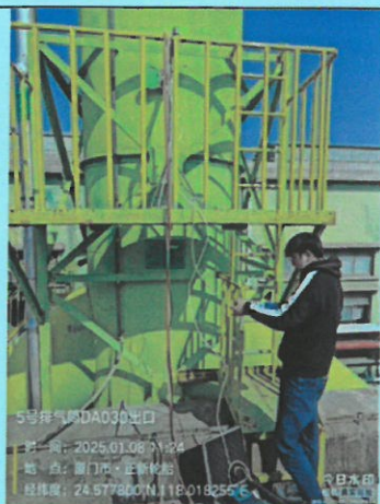
05 硫化车间排气筒出口 DA030 (5 号排气筒)
