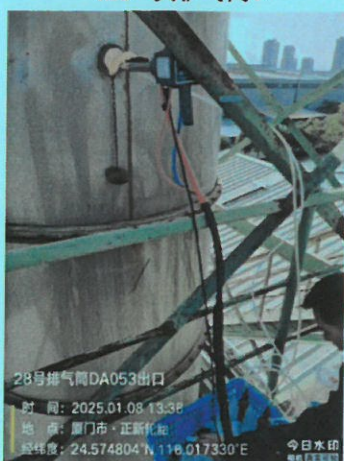
203 硫化车间排气筒出口 DA053 (28 号排气筒)
