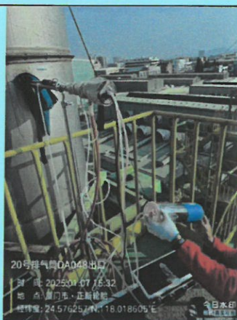
503 硫化车间排气筒出口 DA048 (20 号排气筒)
