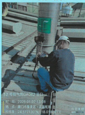
303 硫化车间排气筒出口 DA042 (12 号排气筒)
