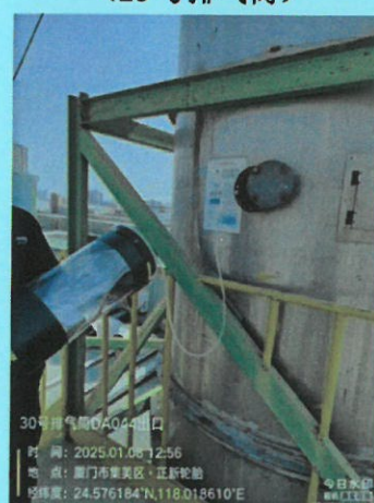
306 硫化车间排气筒出口 DA044 (30 号排气筒)
