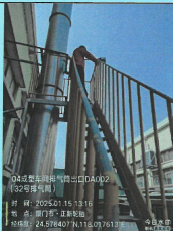
04 成型车间排气筒出口 DA002 (32 号排气筒)
