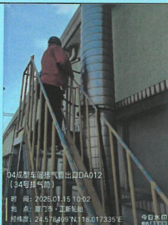
04 成型车间排气筒出口 DA012 (34 号排气筒)
