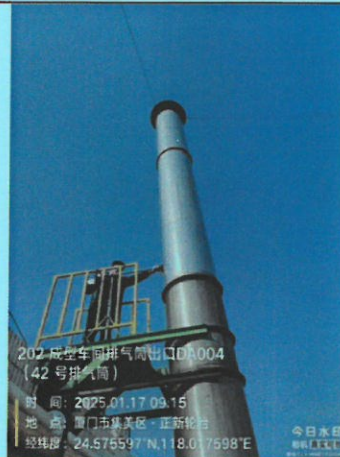
202 成型车间排气筒出口 DA004 (42 号排气筒)
