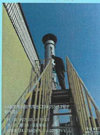
14 配药车间排气筒出口 DA055 (51 号排气筒)
