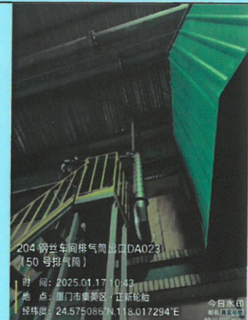
204 钢丝车间排气筒出口 DA023 (50 号排气筒)
