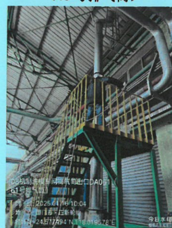
08 机制洗模车间排气筒出口 DA061 (61 号排气筒)
