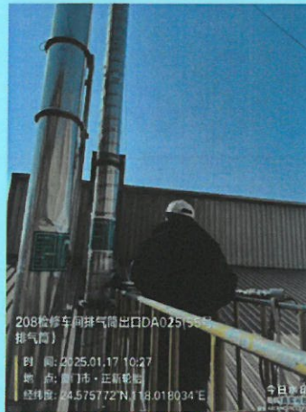
208 检修车间排气筒出口 DA025 (55 号排气筒)
