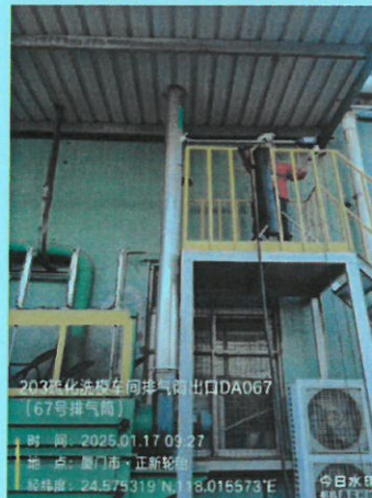
203 硫化洗模车间排气筒出口 DA067 (67 号排气筒)
