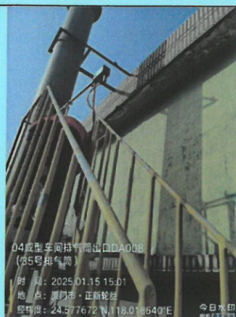
04 成型车间排气筒出口 DA008 (35 号排气筒)
