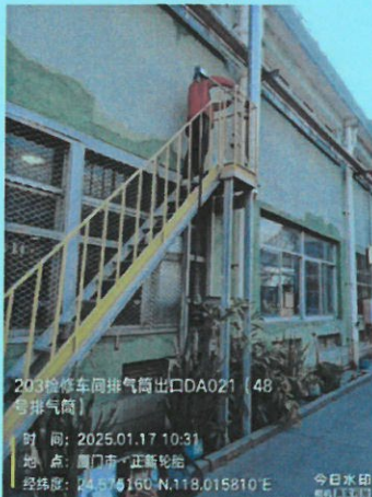
203 检修车间排气筒出口 DA021 (48 号排气筒)
