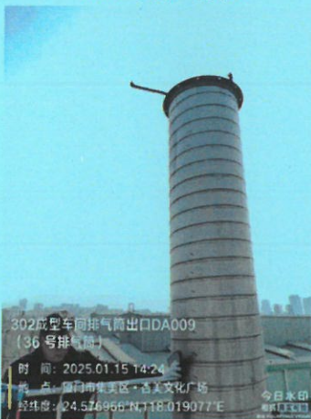
302 成型车间排气筒出口 DA009 (36 号排气筒)
