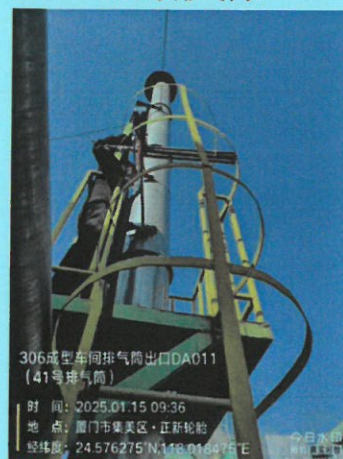
306 成型车间排气筒出口 DA011 (41 号排气筒)
