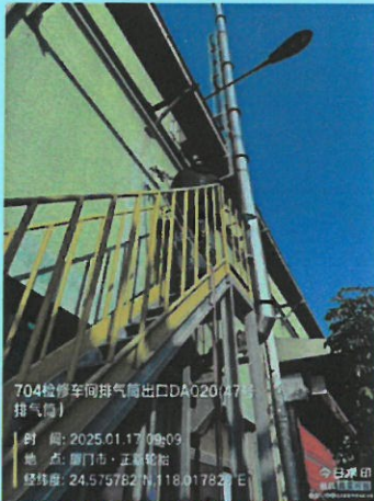
704 检修车间排气筒出口 DA020 (47 号排气筒)
