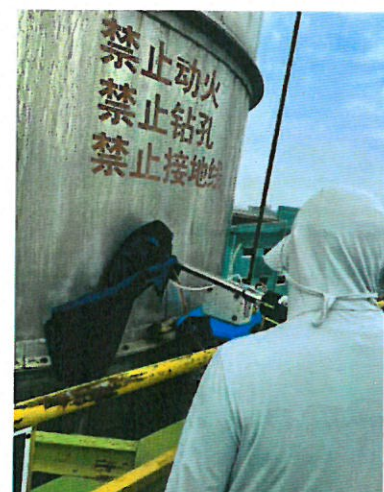
505 硫化车间排气筒出口 (DA016)
